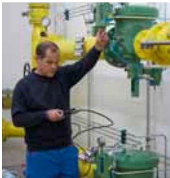
André Becker führt vor der Inbetriebnahme der Gas-Station letzte Messungen durch.
